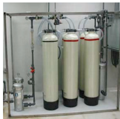
Exemple d'unité de traitement par résines
